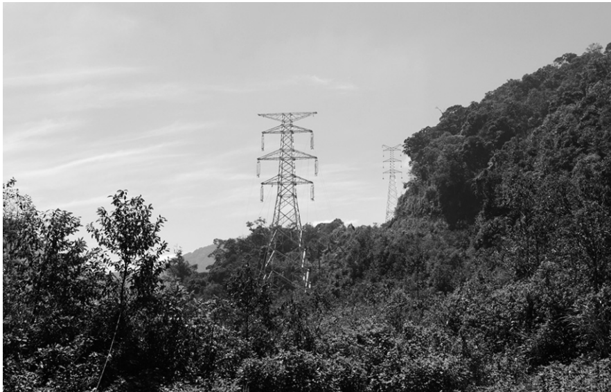
● Vị trí số 0 thuộc lãnh thổ nước bạn Lào đang chờ các thủ tục để kéo dây đấu nối với vị trí số 1 đường dây thuộc lãnh thổ Việt Nam.
