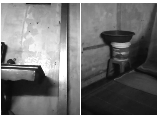
● Gần 5 năm qua, mỗi khi trời mưa, tường và nền nhà bà Lan lại bị hắt nước.
