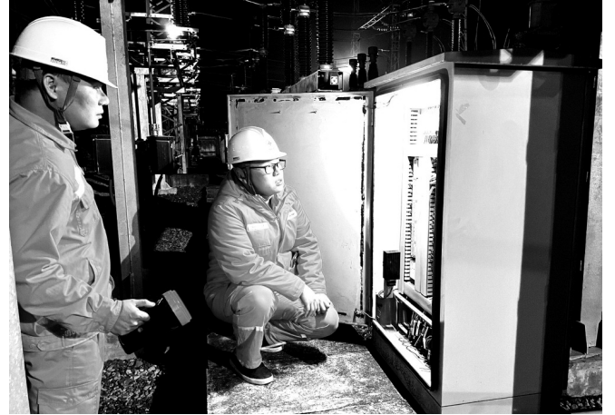
● Công nhân điện lực trực vận hành hệ thống điện 24/24h.
