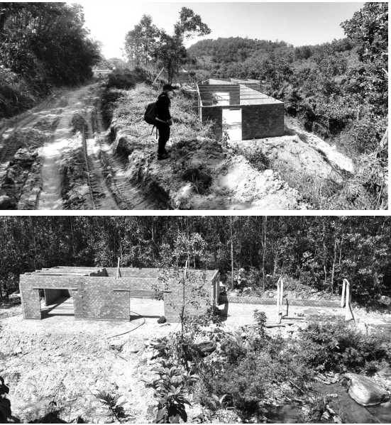
● Những công trình trái phép nằm sát đường dẫn hồ chứa nước Hồ Khế, một số diện tích hơn 100m².
