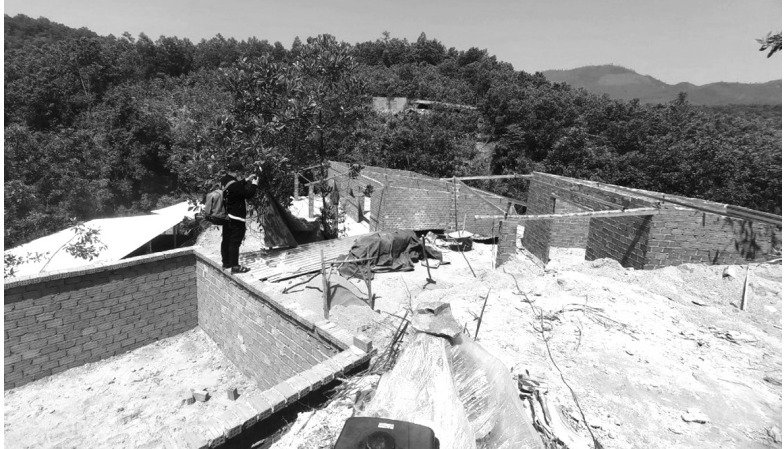
● Qua kiểm tra thực địa, hiện có gần 60 công trình, vật kiến trúc xây dựng trái phép nhằm trục lợi bồi thường.
