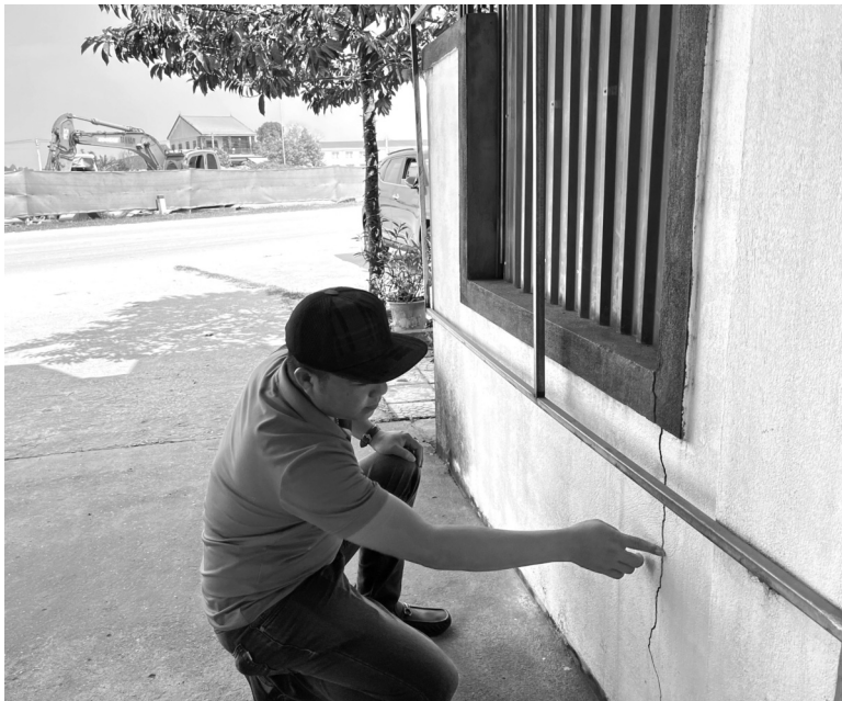
● Một vết nứt của nhà dân tại xã Nghi Phong.
