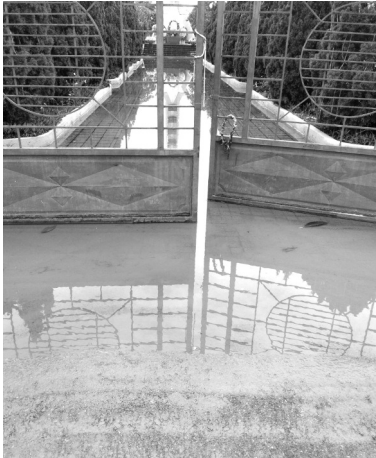
●Nghĩa trang liệt sỹ ngập nước sau mỗi trận mưa lớn. (Hình: người dân cung cấp)
