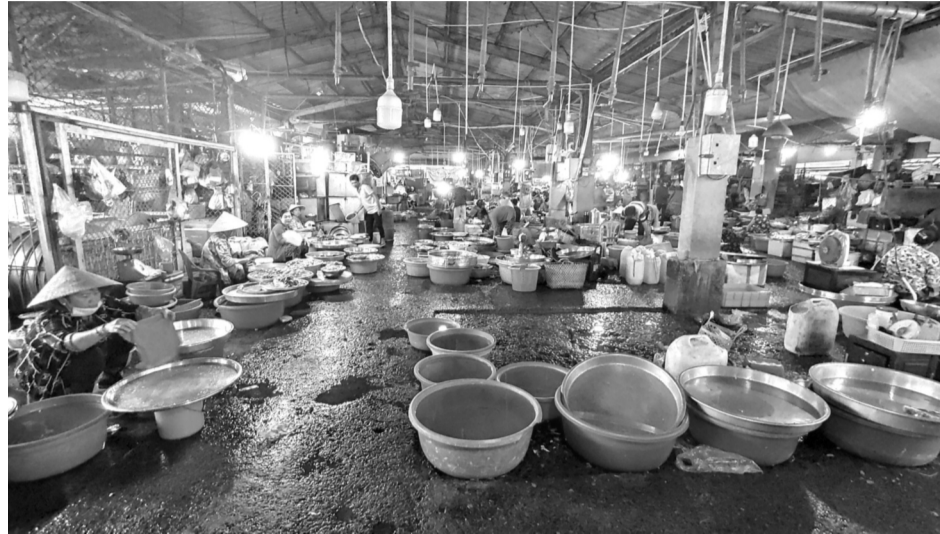
● Phần sàn của khu chợ cá, nền bê tông đã rất cũ. (Ảnh: Kim Loan/vovgiaothong)
