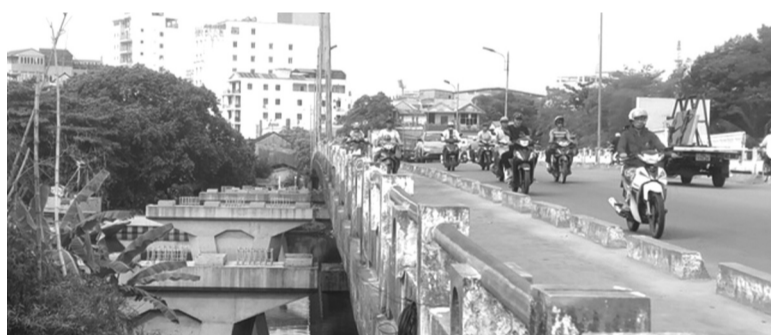
● Sau hơn 2 năm thi công, công trình mở rộng, nâng cấp cầu Vỹ Dạ vẫn “án binh bất động” do thiếu mặt bằng. (Ảnh: Thùy Nhung)
